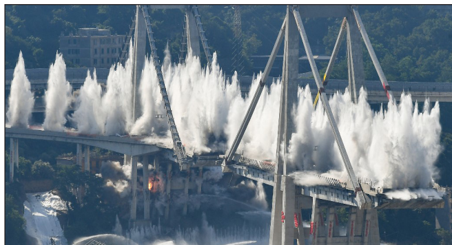
4. ábra: A Morandi-Viadukt vége © Keystone-sda.ch
